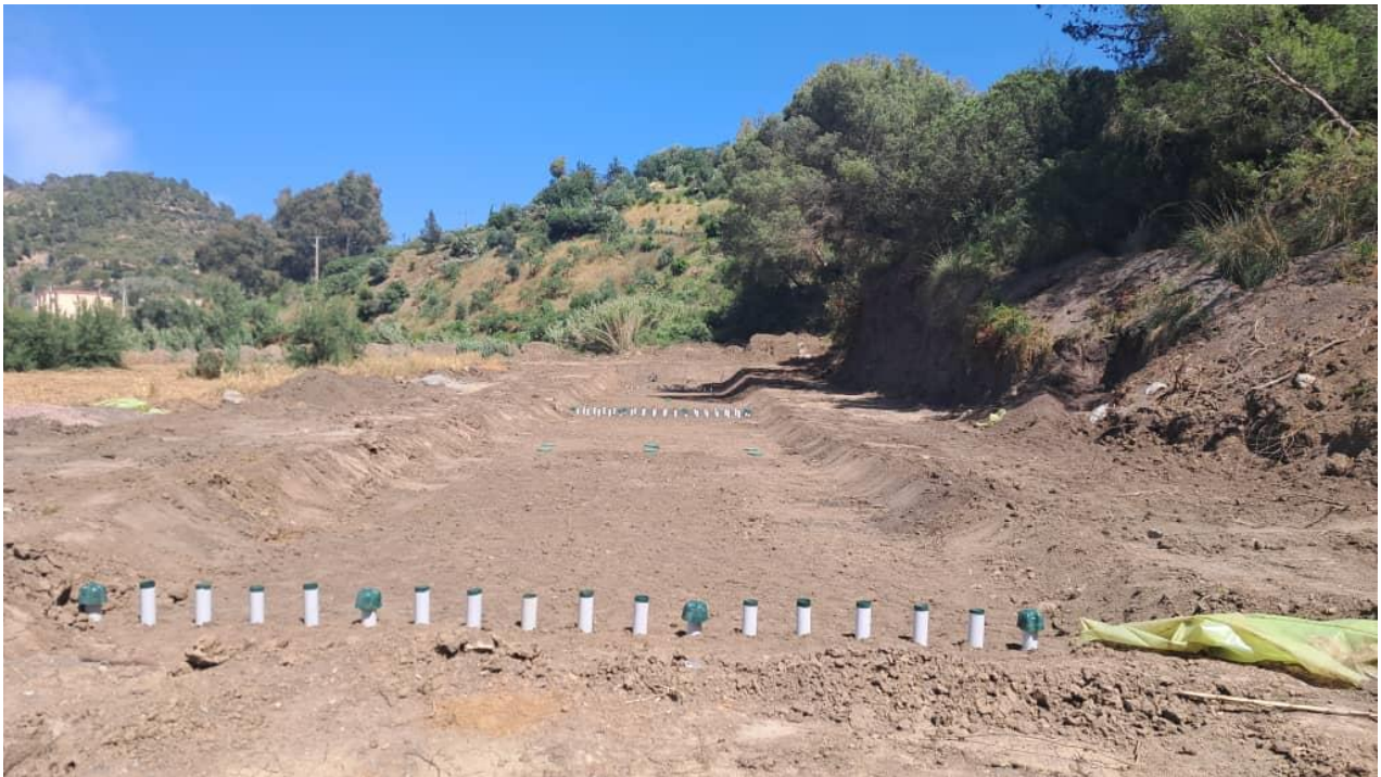
Station d'épuration finalisée
