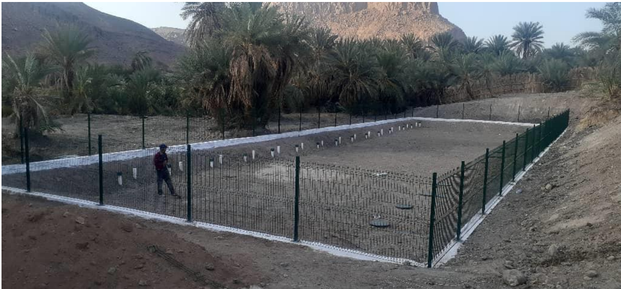
Travaux de mise en œuvre de la station d'épuration de Hay AMKAMAK.
